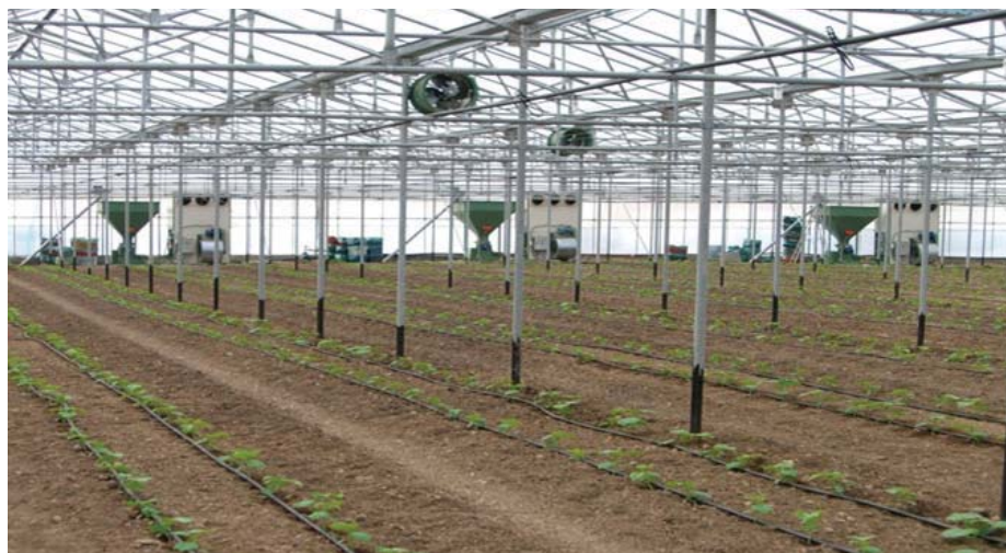
Termogeneratori na biomasu u koji zagrevaju plastenik
