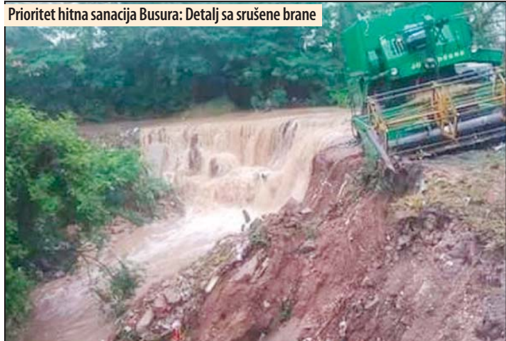
Prioritet hitna sanacija Busura: Detalj sa srušene brane
